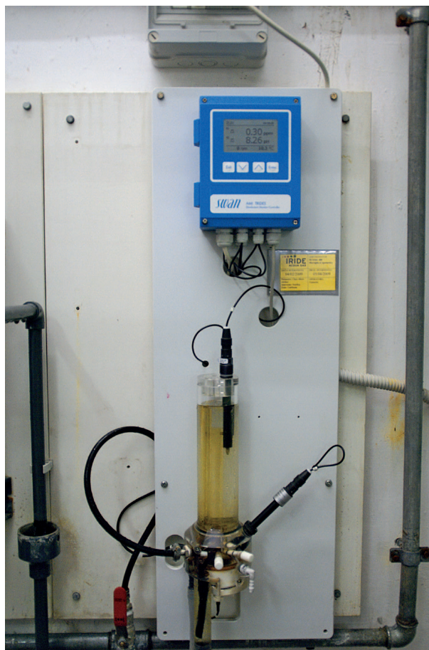
2 - Monitor AMI Trides installato presso un potabilizzatore di Mediterranea delle Acque
